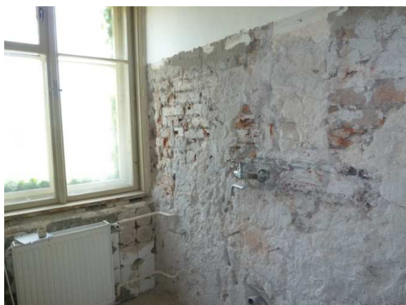
desinfekční místnost v době modernizace
