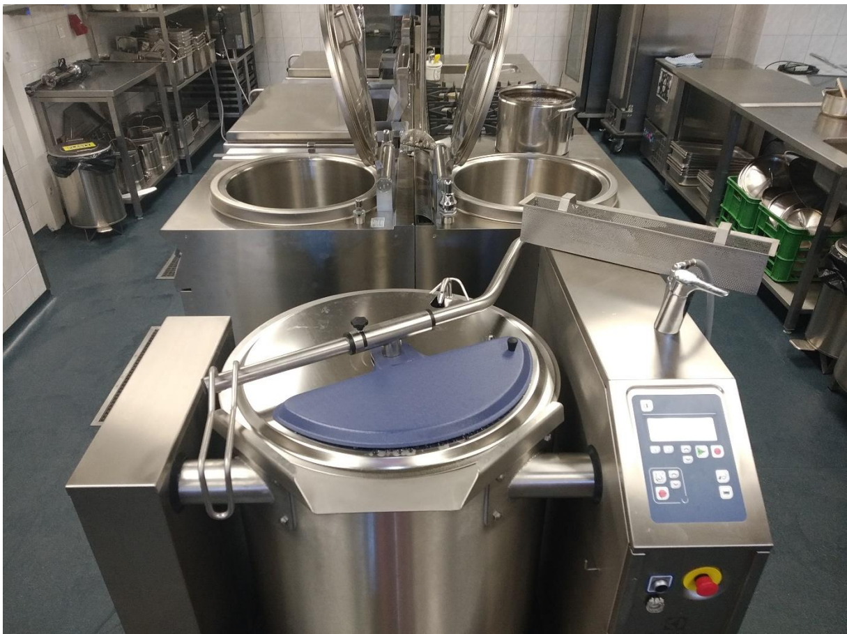
Nové kuchyňské vybavení po záplavě
